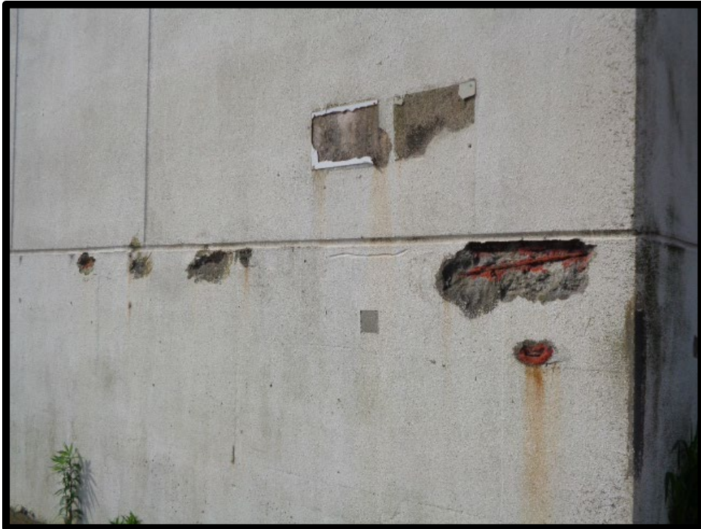
解体建屋(コンクリートの劣化が激しい外壁)
