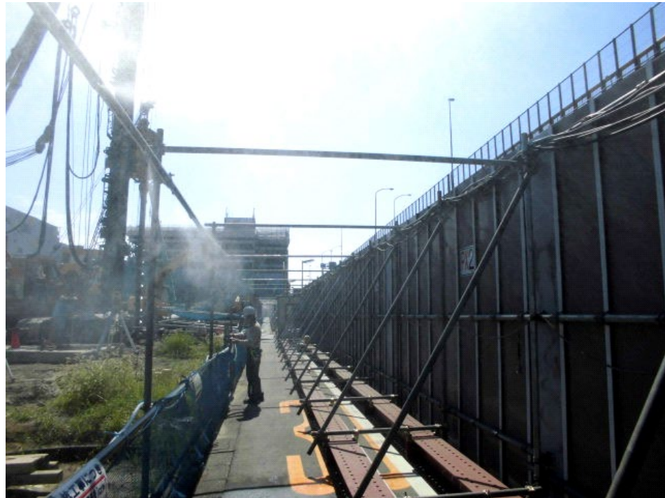
ミスト噴射状況 (作業通路)
