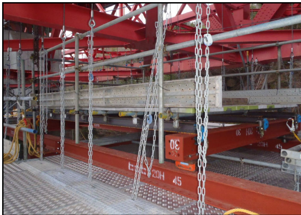
軌条レール・チルタンク・受入架台
