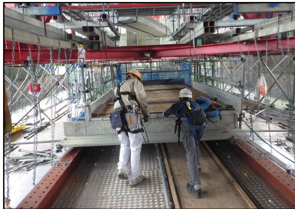
受入架台による 開口部の（閉）状況
