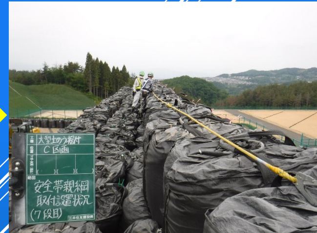
上部据付状況 (高所作業+フレコン 上部凹凸躓き転倒 のリスク大)
