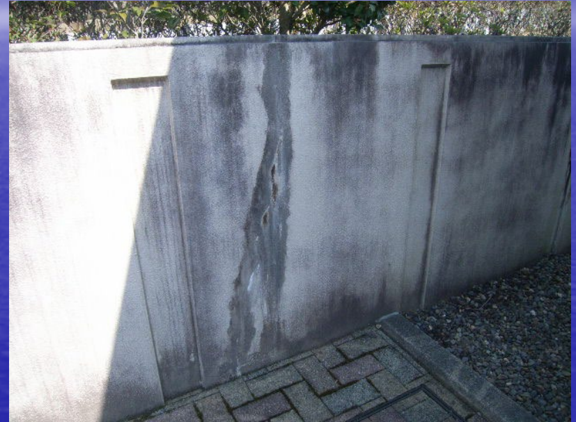
参考写真②－コンクリート表面状況
