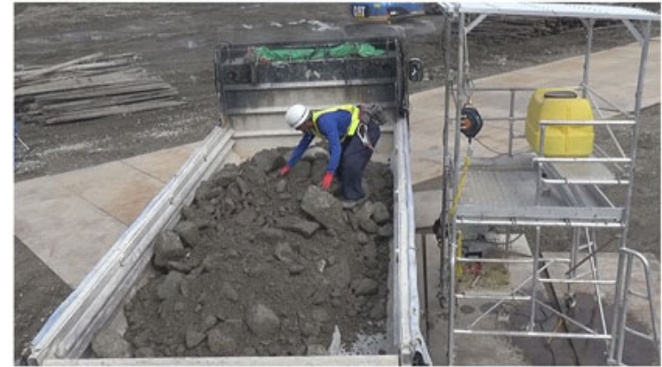
車両荷台での分別作業 (鉄筋屑やゴミ等を取り除きます)
