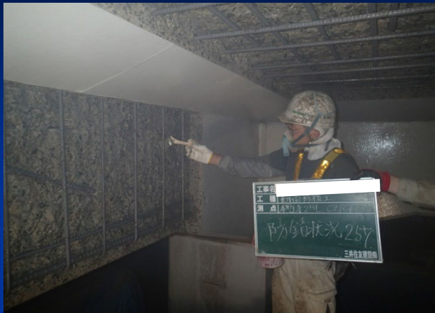
5. 鉄筋防錆状況
