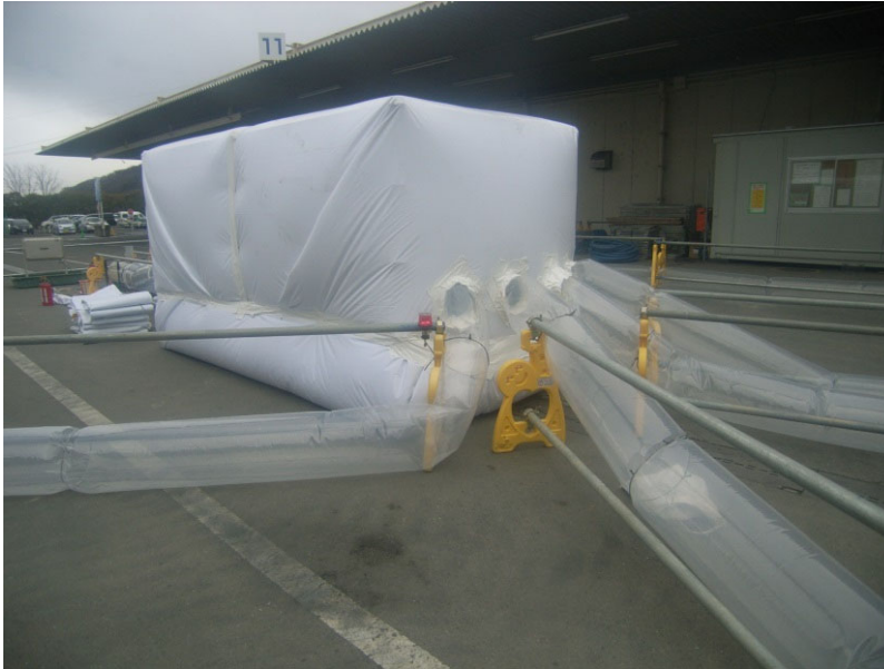
温風の分岐設備からの吐出し口
