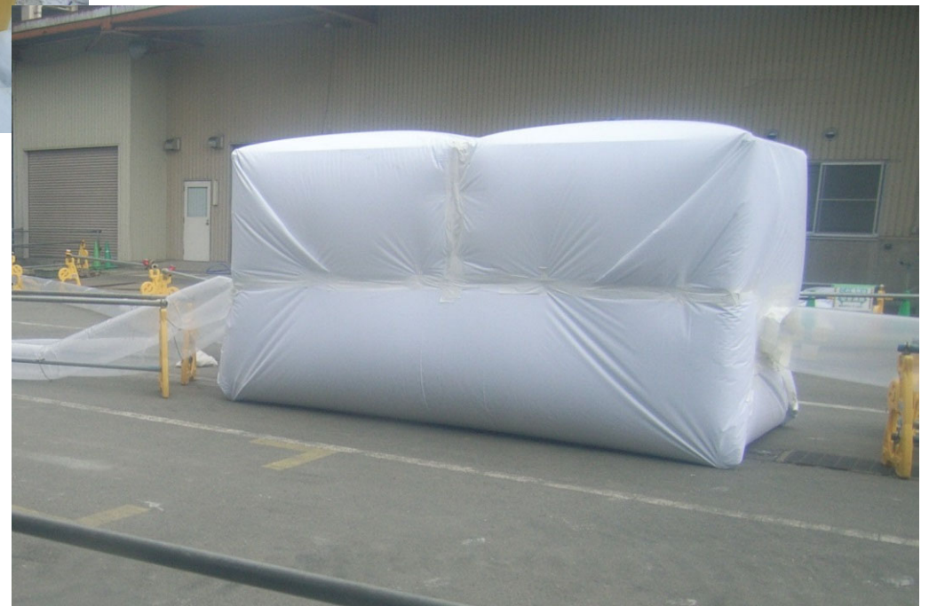
温風の分岐設備
