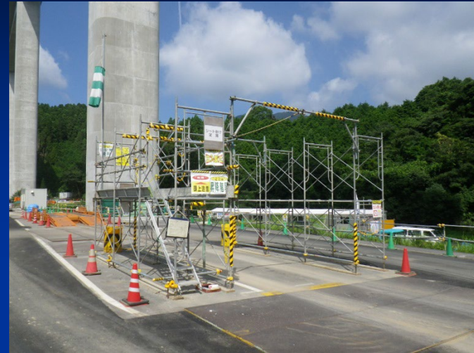
ダンプシートかけ設備
