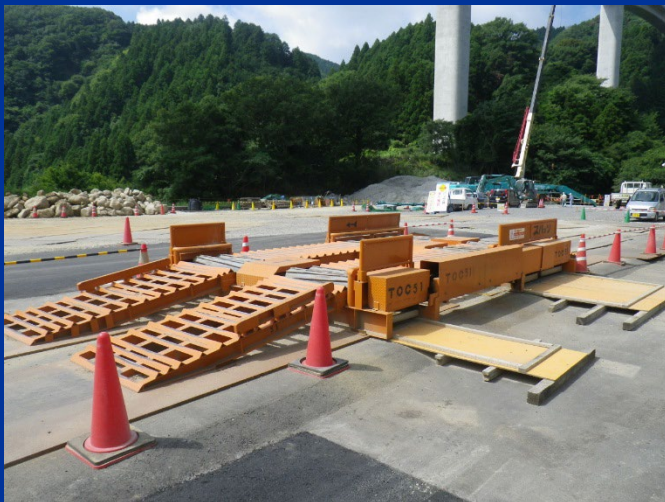
スパッツ設備
