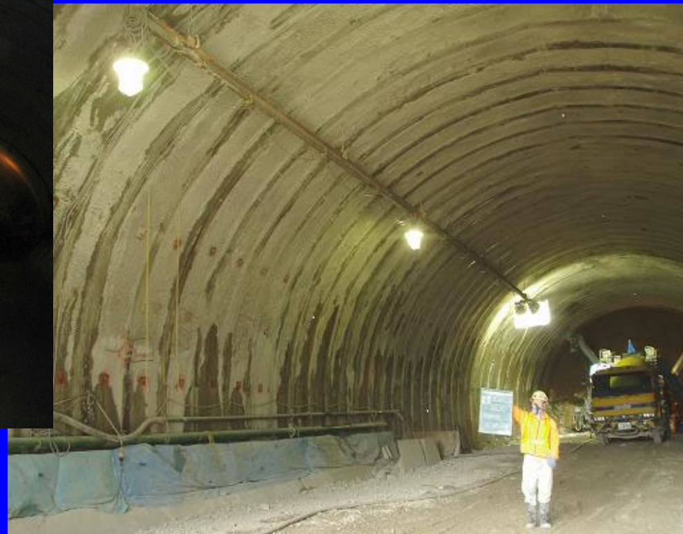
伸縮式風管のレールを利用(自走式)
